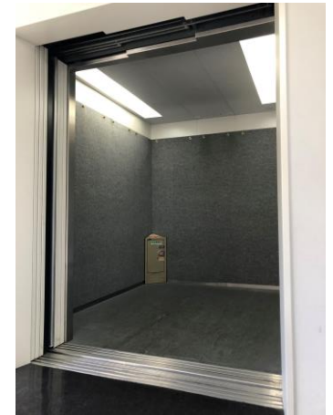
貨物用エレベーター
